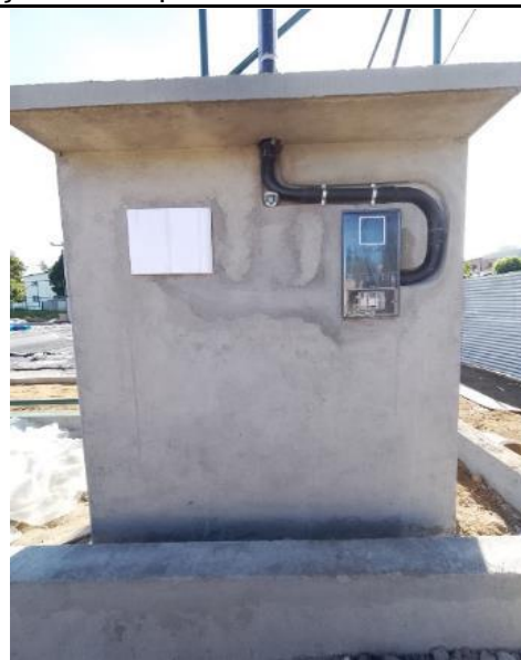
Foto 48 - Mureta do padrão de energia.
