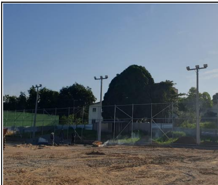
Foto 29 - Postes de Iluminação.
