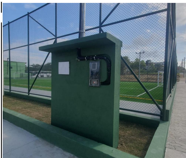
Foto 49 - Mureta do padrão de energia.
