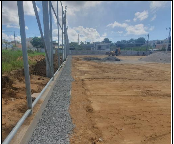
Foto 36 - Sistema de drenagem do campo.
