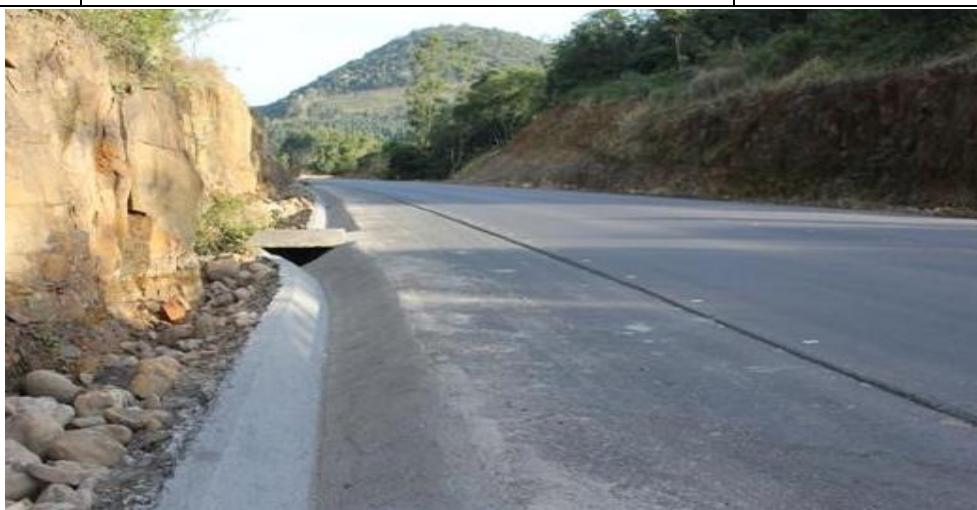
Figura 30: Sarjeta e boca de lobo. Estruturas de drenagem projetadas para a rodovia.
