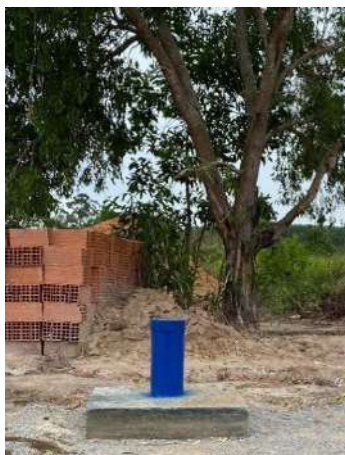
Figura 6-2: Poço artesiano, Aldeia Córrego do Ouro.
