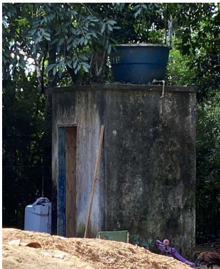
Figura 7-2: Condições dos banheiros, Aldeia Boa Esperança
