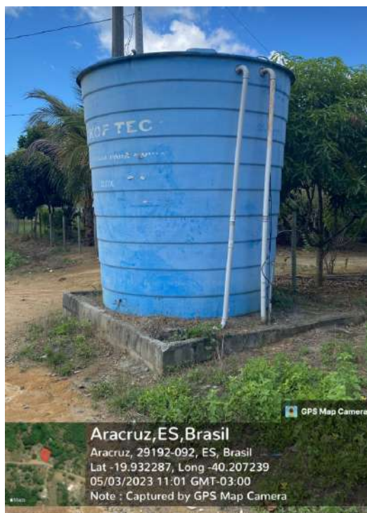
Figura 6-7: Reservatório apoiado da comunidade de Lajinha
