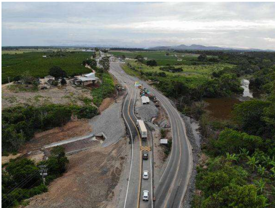
Figura 9-34: Trecho da BR-101 parcialmente liberado após rompimento causado pelas fortes chuvas de 2022.
