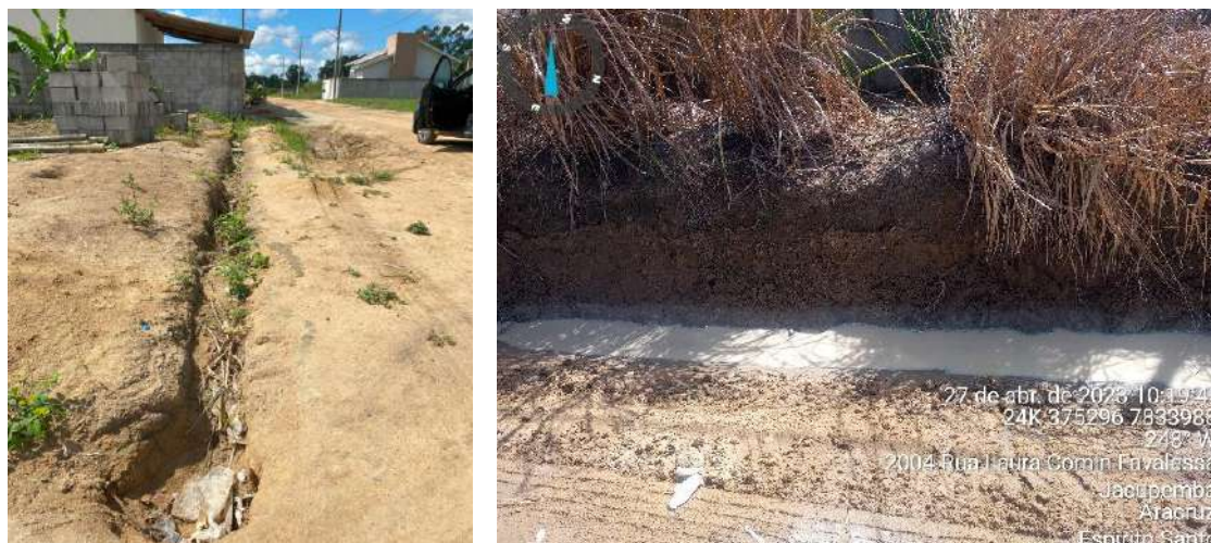
Figura 9-74: Valas de drenagem feitas pelos moradores.
