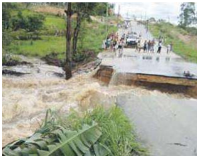
Figura 9-32: Rompimento da Rua Luiz Rossato nas chuvas de 2014.
