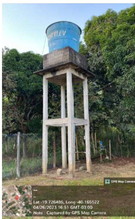
Figura 6-2: Reservatório da comunidade de Cachoeirinha do Riacho
