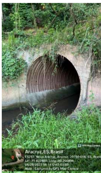
Figura 9-23: Bueiro de transposição da ES-257 1,80m de diâmetro (a) Acesso ao loteamento Morada Park (b).
