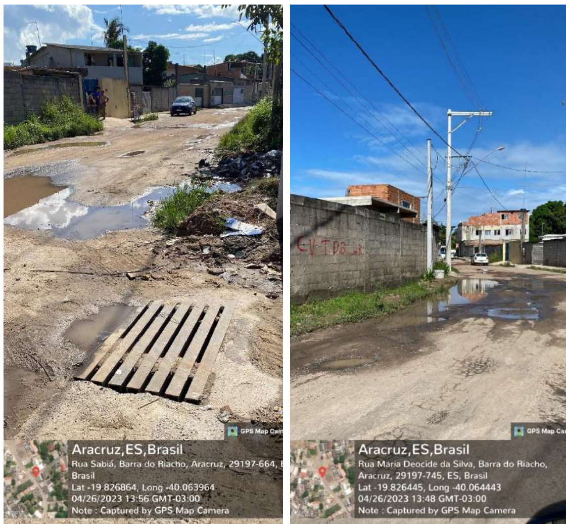
Figura 9-47: Vistas da Rua Mauro de Oliveira Cunha próximo à desobstrução realizada rotineiramente pelos moradores em épocas de chuva.
