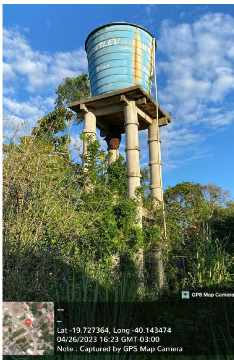
Figura 6-9: Reservatório elevado da comunidade de Sertão do Congo
