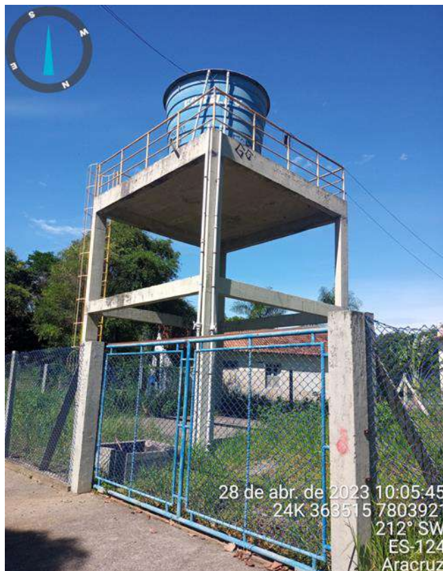
Figura 6-6: Reservatório elevado da comunidade de Grapuama
