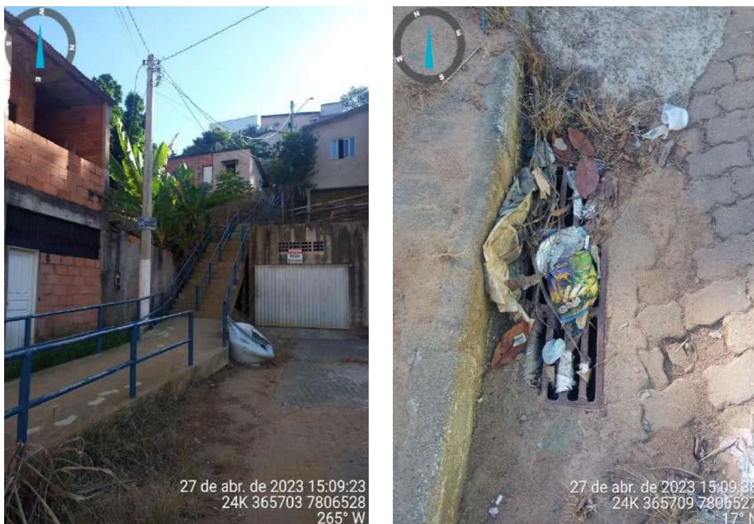
Figura 9-68: Escadaria Santa Luzia sem obra de drenagem associada (a) resíduos sólidos e necessidade de limpeza e manutenção no sistema de drenagem do bairro Santa Luzia (b)
